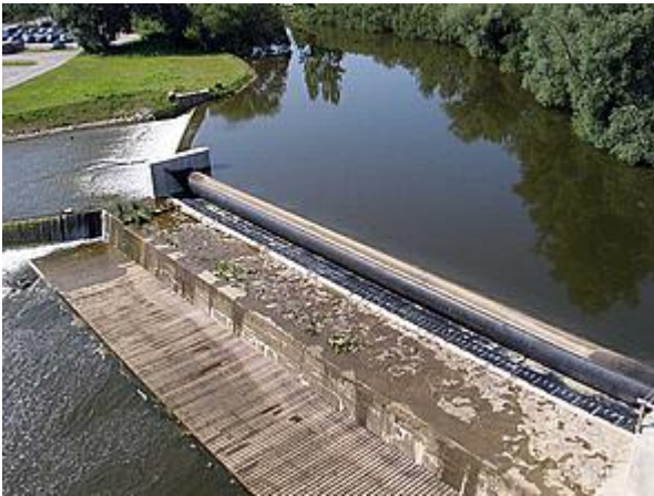
Mit dem Schlauchwehr wird der Hochwasserdurchfluss gesteuert
