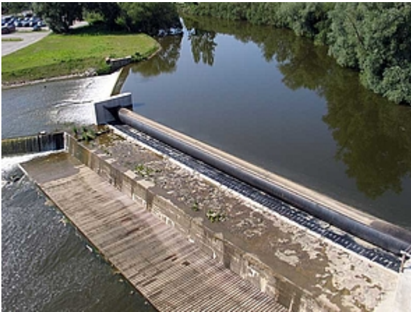
Mit dem Schlauchwehr wird der Hochwasserdurchfluss gesteuert
