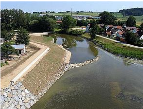
Unterwasser der Turbine mit Leitbuhne
